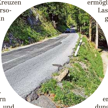
Die Klöntalerstrasse ist in einem schlechten Zustand
